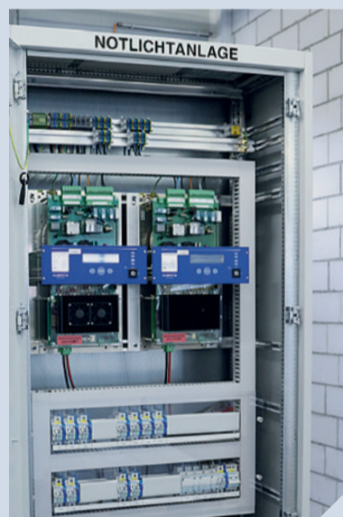
Gruppenbatteriesystem ASG LPS 230 V AC
